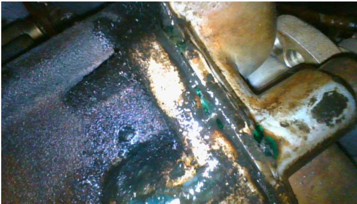
Kühlwasseraustritt aus der Leckagebohrung
